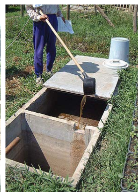
バイオガス液肥貯留槽
