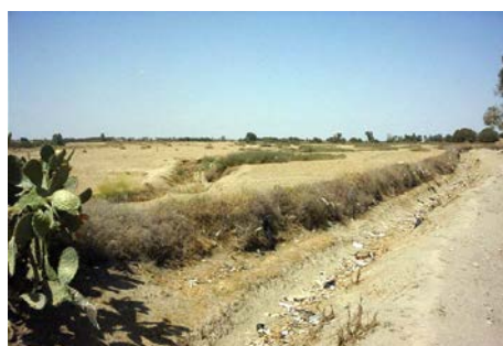
改修が必要な On Farm Canal （いずれもモロッコ）
