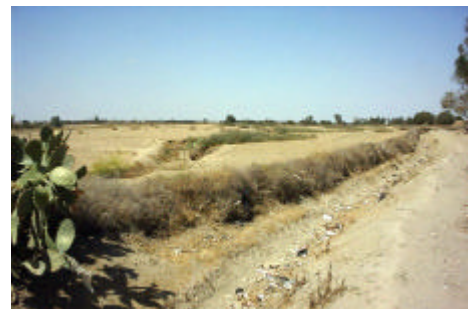
改修が必要な On Farm Canal （いずれもモロッコ）
